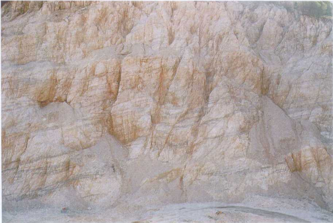
Fotografía 3. Erosión del talud principal de Sierra Llana.
